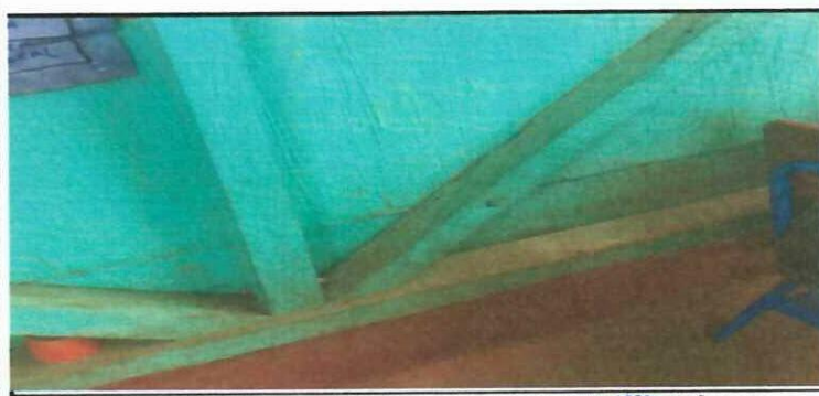
Foto 11: Las reglas que sirven de columnas en la estructura de madera se encuentran ya en mal estado.
