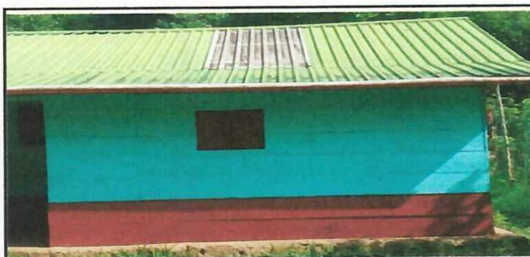
Foto 9: La infraestructura de la dirección se encuentra en pesimas condiciones, la madera esta picada al igual que el piso y sus laminas ya se encuentran deterioradas.
