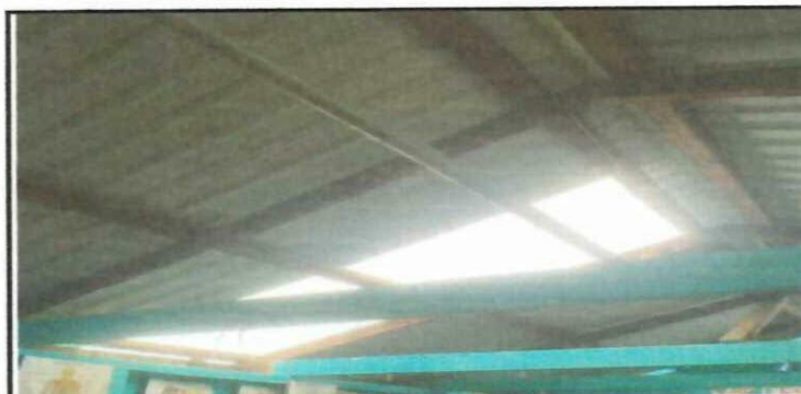
Foto 10: Las vijas del aula de los niños son de madera picada que se encuentra en malas condiciones.
