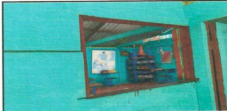
Foto 4: La ventana del aula de los estudiantes, es de madera y es el unico medio de ventilación, se encuentra en mal estado, por lo que no brinda seguridad para los bienes que se encuentran dentro del aula.
