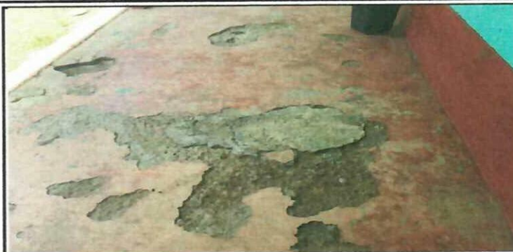
Foto 8: El piso de todo el establecimiento se ha picado y esto ha generado algunos hoyos que son peligrosos para los niños.
