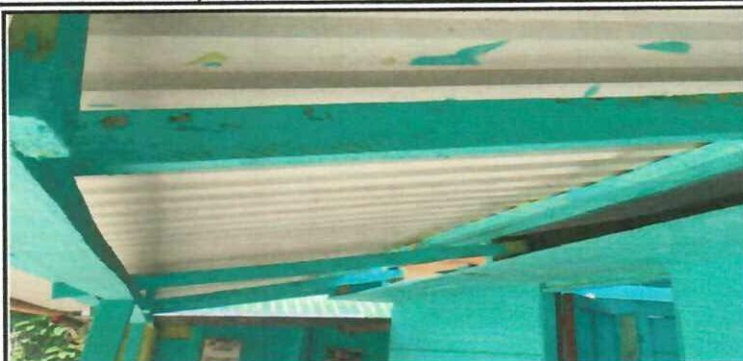
Foto 7: Las vigas de todo el establecimiento se encuentran picadas y en mal estado, lo cual no brinda seguridad a los niños.
